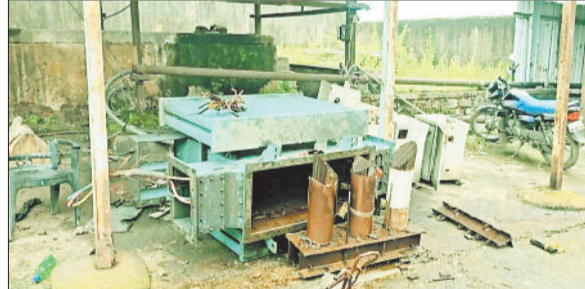
इस तरह ट्रांसफार्मर खोल कर केबल ले उड़े चोर।
